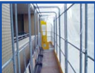
飛散防止フレーム
